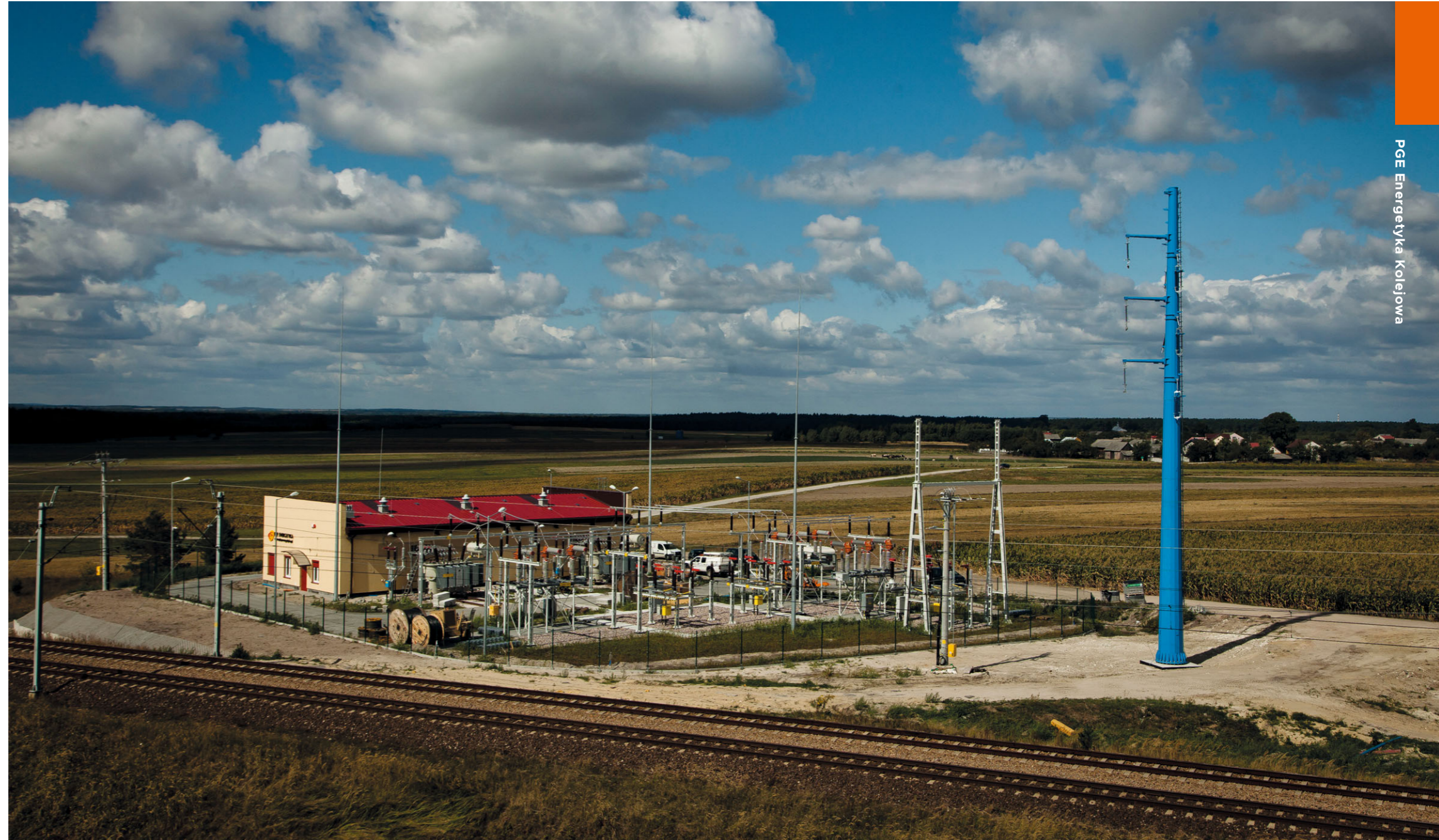
PGE Energetyka Kolejowa, GPZ
