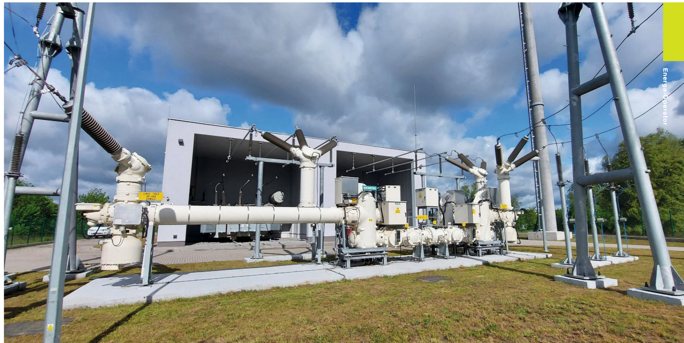
Energia-Operator, GPZ Maćkowy
