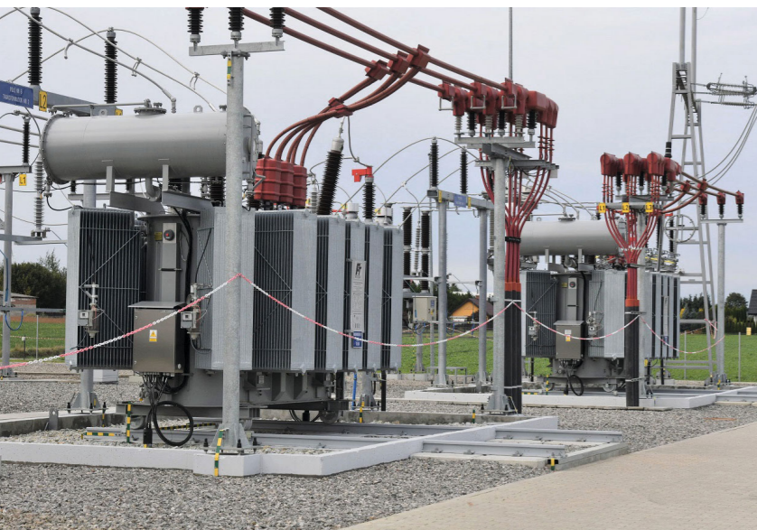
PGE Dystrybucja, Stacja 110/15 kV Wilkołaz
