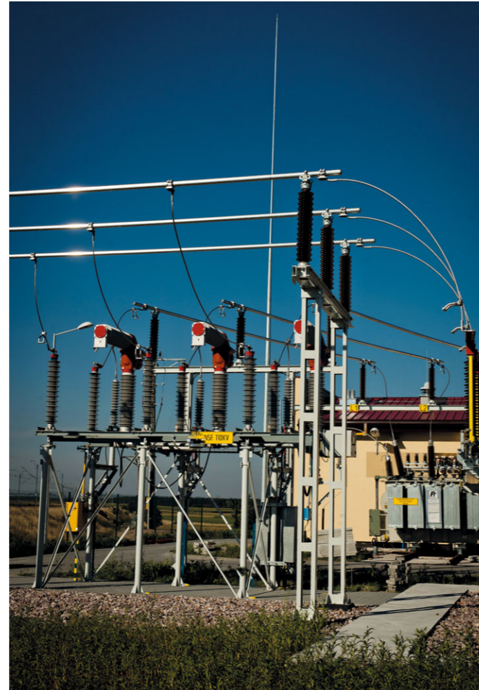
PGE Energetyka Kolejowa, GPZ
