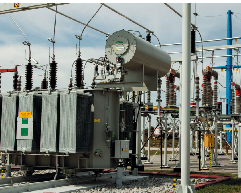
PGE Energetyka Kolejowa, GPZ
